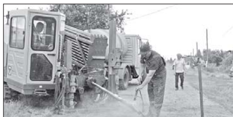
Замена водопроводных сетей во всем селе - единственный проект в регионе, который реализуется в Уртаме с 2019 года. 3 стр.
